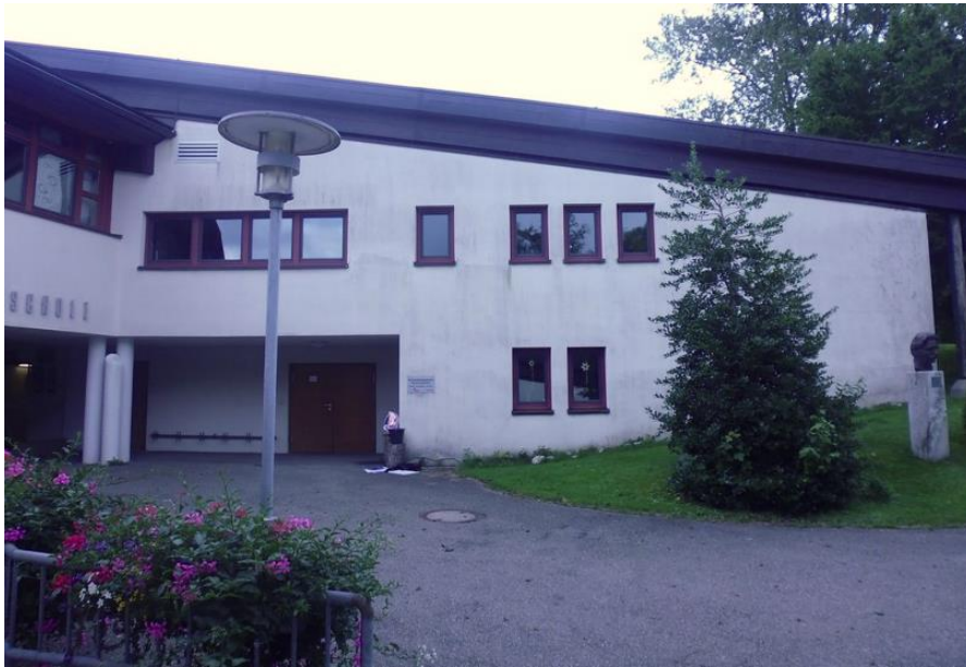
Bild 1: Zustand Fassade Eingangsbereich
