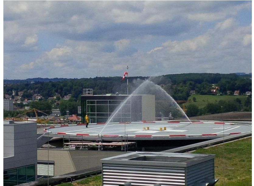
Test der Löschanlage Hubschrauber
