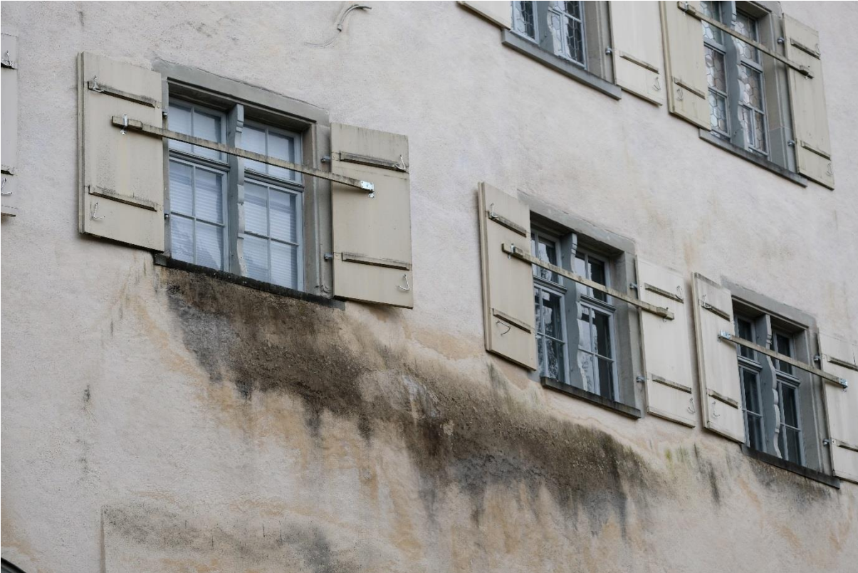
Detail Fassade Ost (Verunreinigungen in Folge eines zu kurzen Fensterbanküberstandes)
