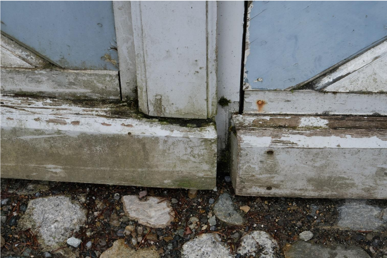
Detail Tor (Wetterschenkel und Füllung im Inneren mit Braunfäule, Verschiebung der Konstruktion!)
