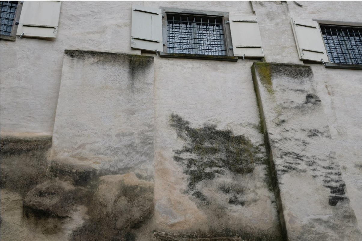
Sockeldetail ( Fassade Süd, Verunreinigungen in Verbindung mit Schimmelpilzbildung)
