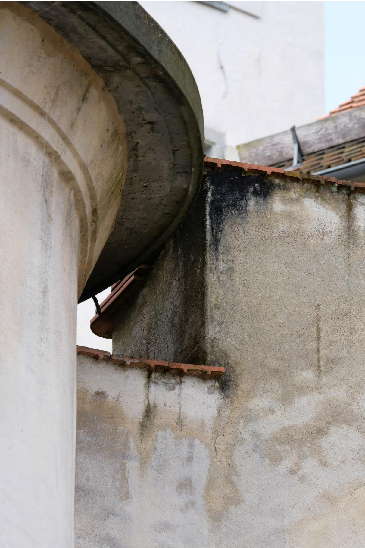
Detail Mauer (Verunreinigung sowie Schimmelpilzbildung, Rissbildung)
